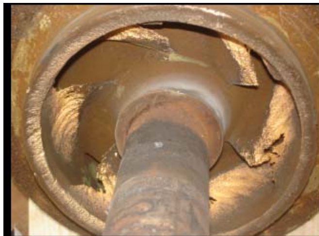
Figura 7.13 Cavitação em bomba no ano 2007
