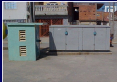
Instalações do booster Vitápolis com inversor de frequência, RMSP
