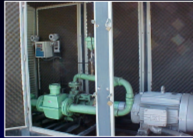
Booster com inversor de frequência instalado no Portal D'Oeste, RMSP
