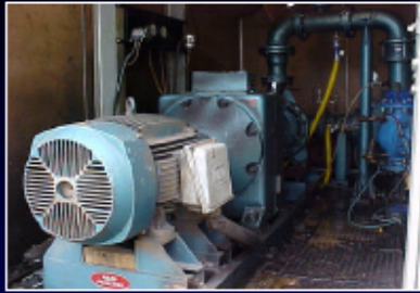
Booster com variador hidrocínético instalado na Conceição, RMSP.
