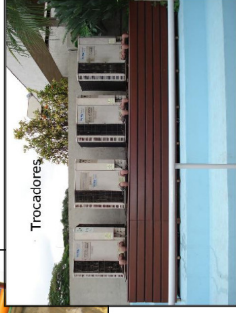
Bomba de Calor
