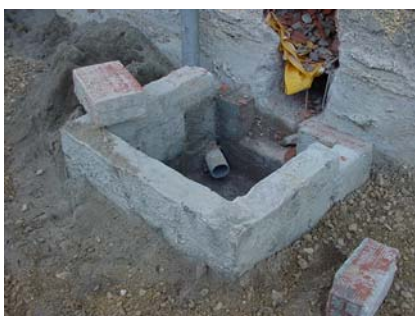
Fig. 16 – Descarga tubo de queda a caixa de visita
