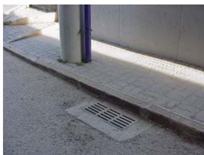
Fig. 17 – Descarga de tubo de queda à sargeta municipal
