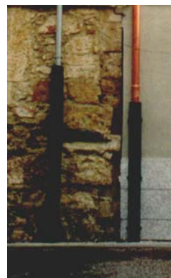
Fig. 20 – Protecção em ferro fundido a eventuais danificações
